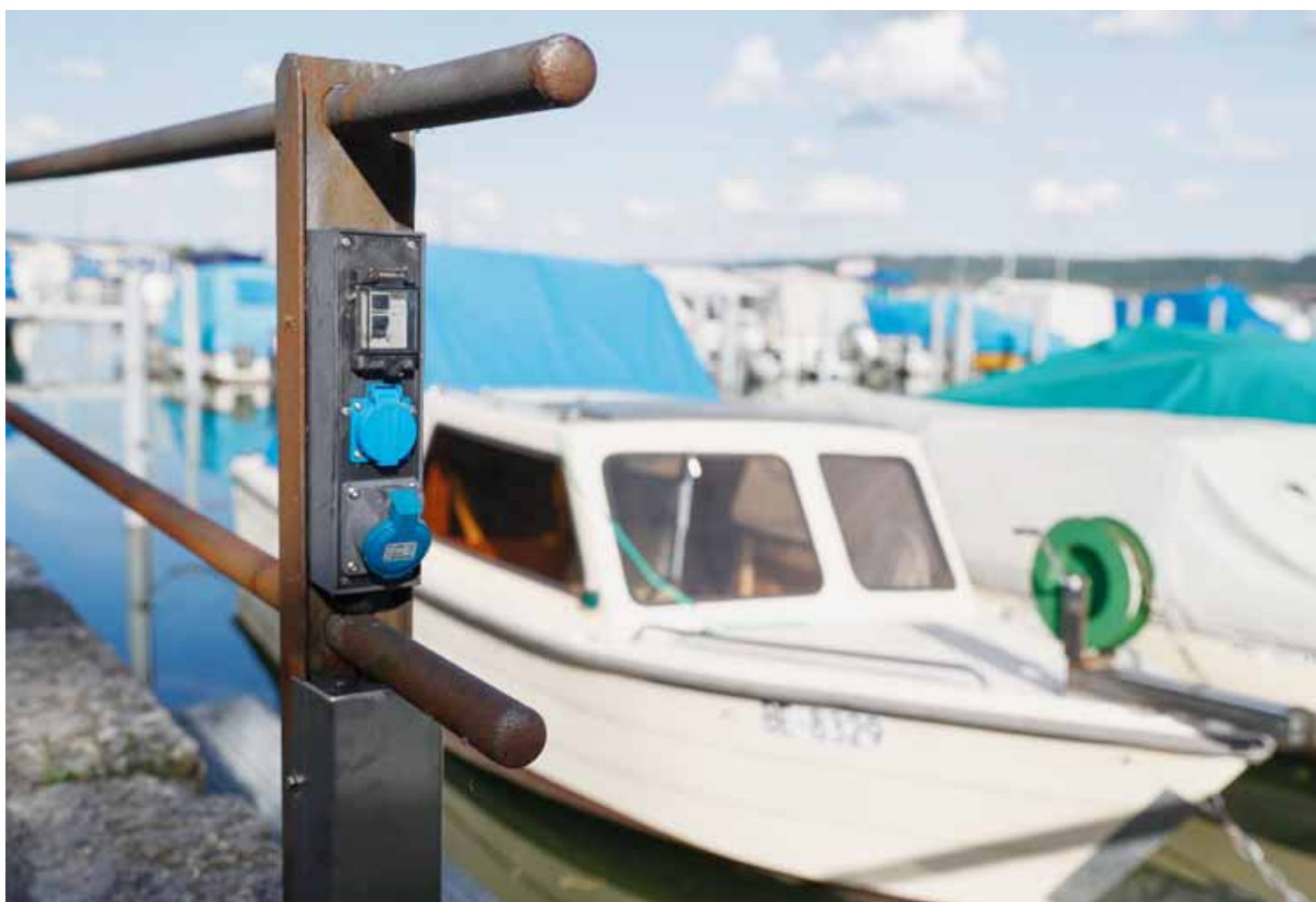
Une des prises situées au port de La Neuveville. Elle est munie d'un système pour couper l'alimentation électrique presque instantanément si le courant se perd, notamment dans l'eau. Ce qui n'a toutefois pas empêché le drame. KEYSTONE
